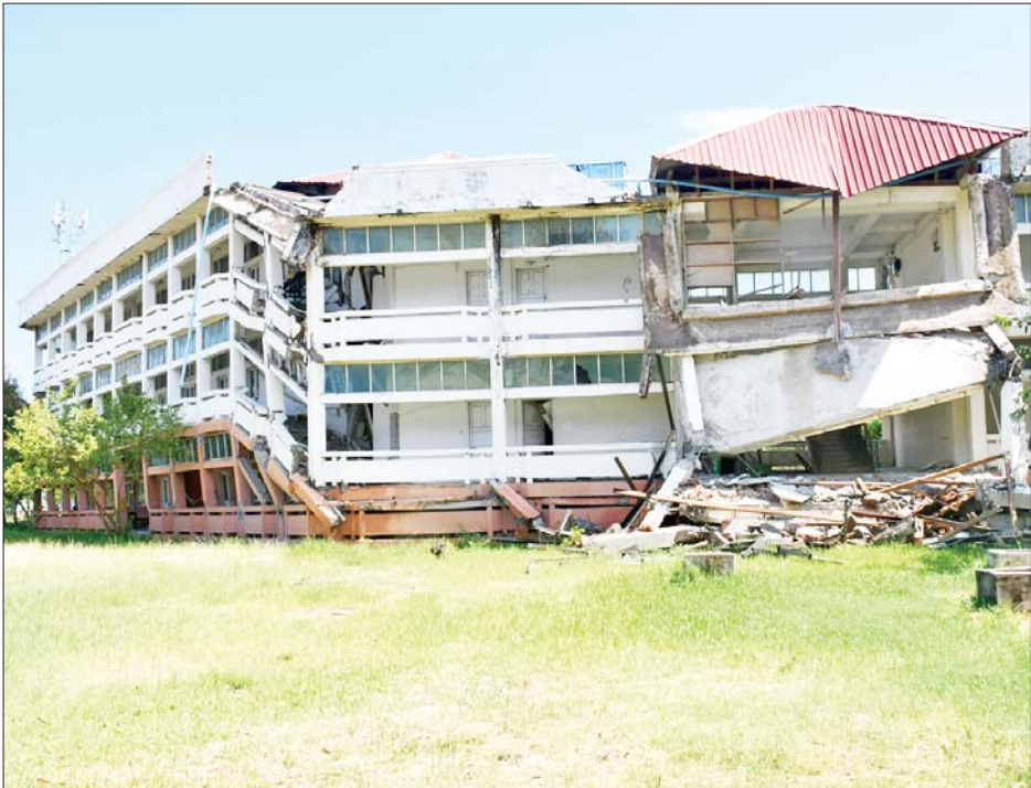
နည်းပညာတက္ကသိုလ်(ကျောက်ဆည်) ငလျင်ဒဏ်ကြောင့် ပျက်စီးခဲ့မှုကို တွေ့ရစဉ်။
