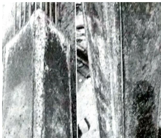
شکل ۸-۱۴- شوره زنی عامل تخریب بتن
