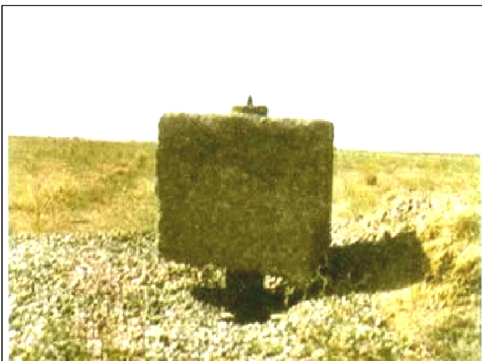
معلق شدن فونداسیون بتنی درپوش چاه مشاهده ای در اثر نشست سراسری زمین (مهییار شمالی)
