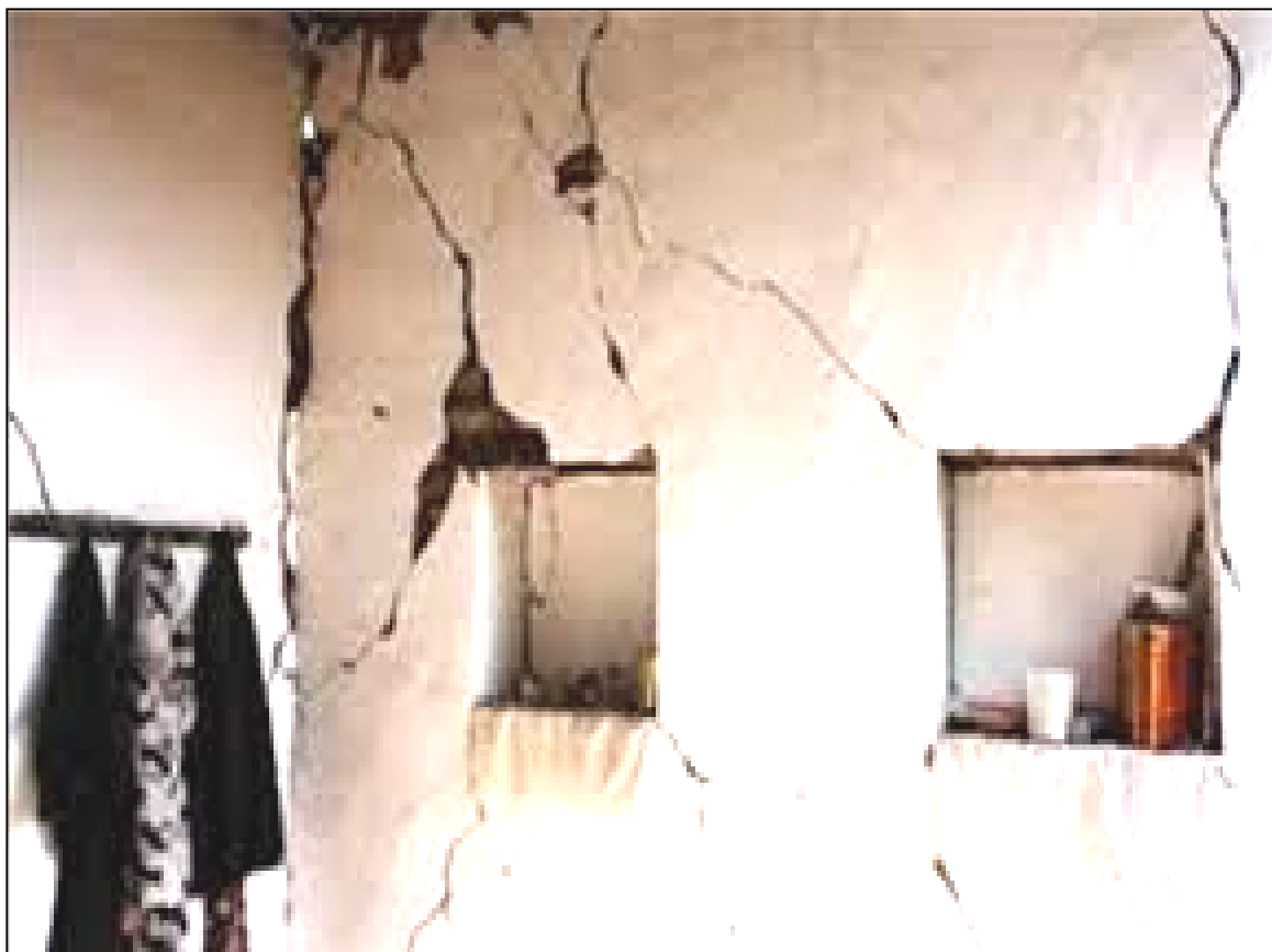
یکی از 320 منزل مسکونی در معرض تخریب در اثر فرونشست زمین در شهر دامنه در حوضه زاینده رود
