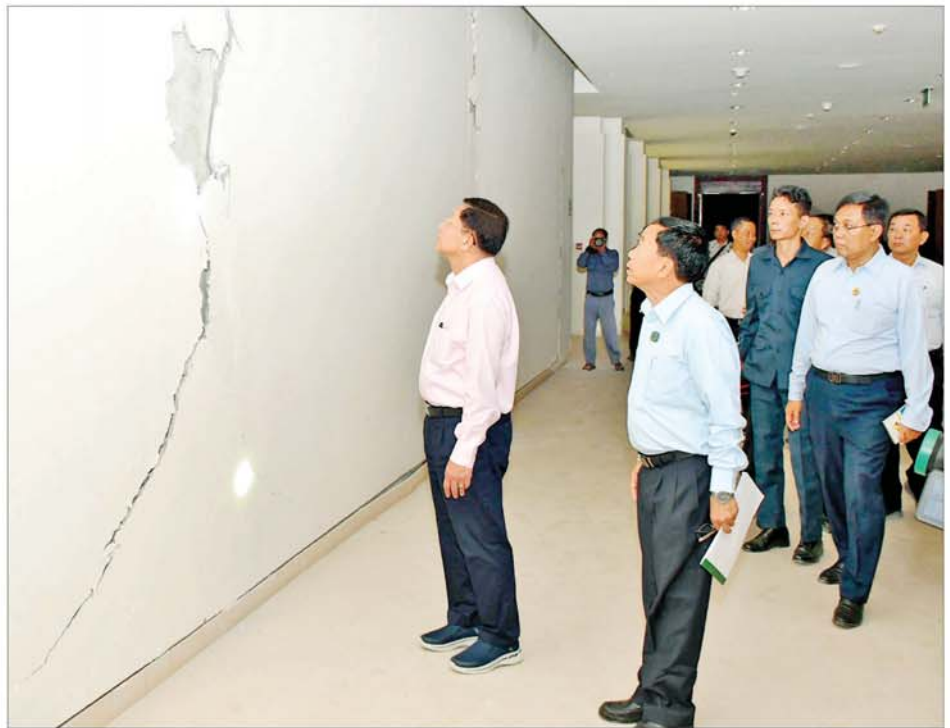
နိုင်ငံတော်ဆိုင်ရာချုပ်ရေးကောင်စီဥက္ကဋ္ဌ နိုင်ငံတော်ဝန်ကြီးချုပ် ဗိုလ်ချုပ်မှူးကြီးမင်းအောင်လှိုင် မြန်မာအပြည်ပြည်ဆိုင်ရာ ကွန်ဗင်းရှင်း ဗဟိုဌာန-၁(MICC-၁) ၌ ငလျင်ဒဏ်ကြောင့် နံရံများ အနည်းငယ်ကွဲအက်နေမှုကို ကြည့်ရှုစစ်ဆေးစဉ်။
