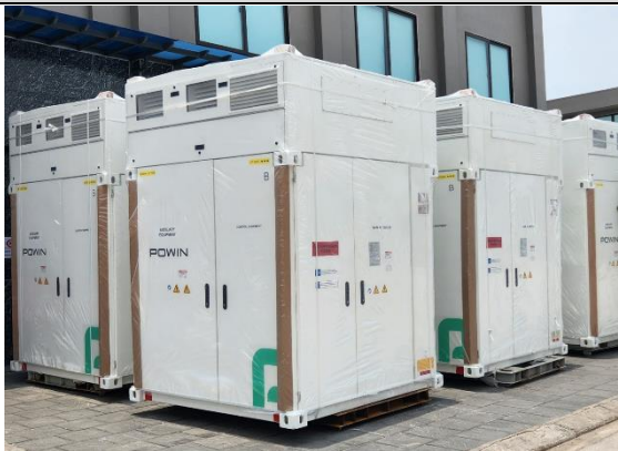
납품 대기 중인 주요 고객사 ESS ②
