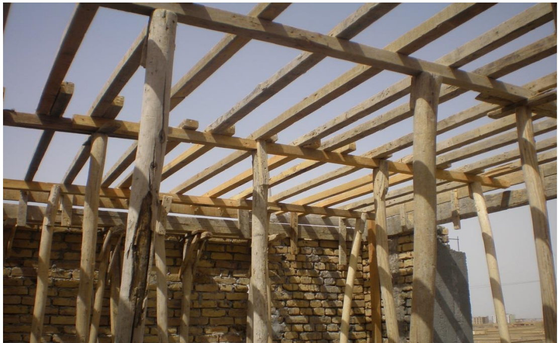
در تصویر فوق موجودیت درز در تخته قالب گادر و موجودیت چوب های فاسد
